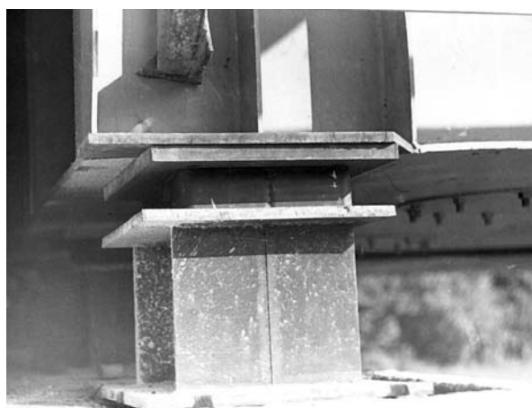
Rys. 15. Pierwsze polskie łożyska elastomerowe nośności 1,2 MN wbudowane zamiennie zamiast łożysk wałkowych w moście na CMK, [4]
